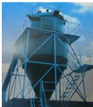
図 8. 中国に使用されている石炭ボイラー排気ガスのアンモニア脱硫装置
