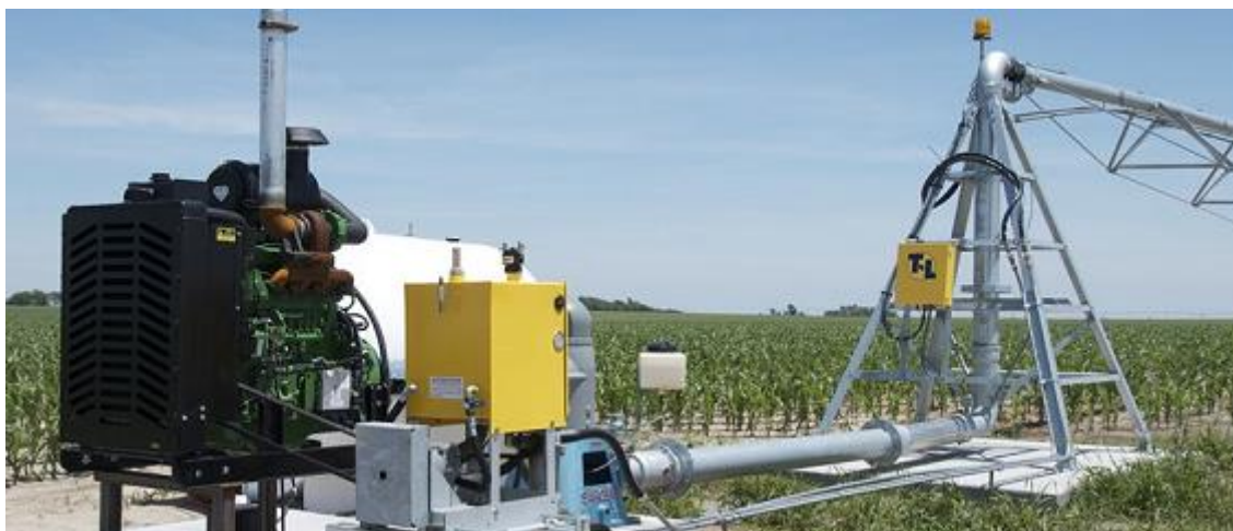
図3. センターピボット灌漑システムの井戸と動力（内燃機から発電して、電力で運転する）
